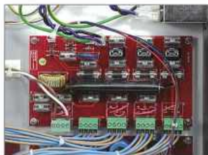
Hier wird der Netzstrom gefiltert, bevor er zu den Trafos gelangt
